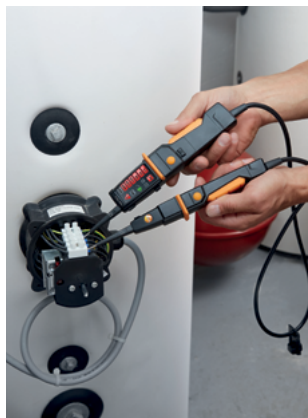
Pomiar napięcia na kotle.
