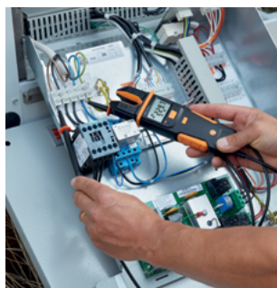
Pomiar napięcia na sprzęzarce.
