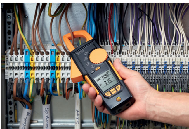
Pomiar prądu w szafach sterowniczych.
