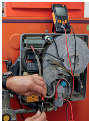
Pomiar prądu jonizacji na palniku kotła.
