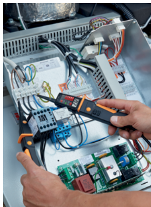
Pomiar napięcia na sprężarce.
