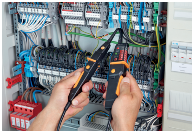
Pomiar napięcia w szafach sterowniczych.
