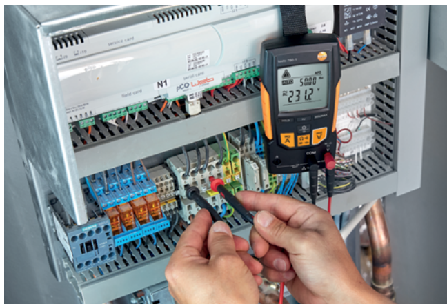
Kontrola napięcia w skrzynce elektrycznej pompy ciepła.
