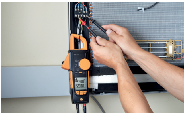
Pomiar napięcia na klimatyzatorze za pomocą testo 770 .
